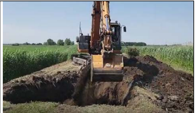
Canale dei Cuori in Comune di Cavarzere. Tamponamento e messa in sicurezza di un'infiltrazione arginale.
