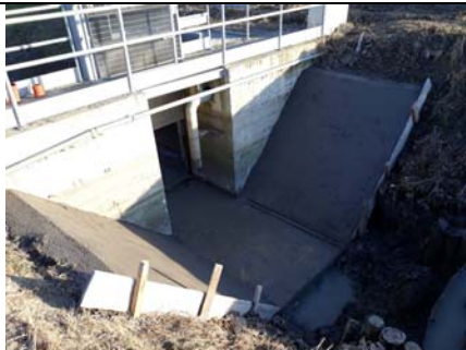
Scolo Cons. Conselve – manufatto di ricollo e rilancio "Conselve 1". Realizzazione rivestimento di fondo e sponde in c.a.
