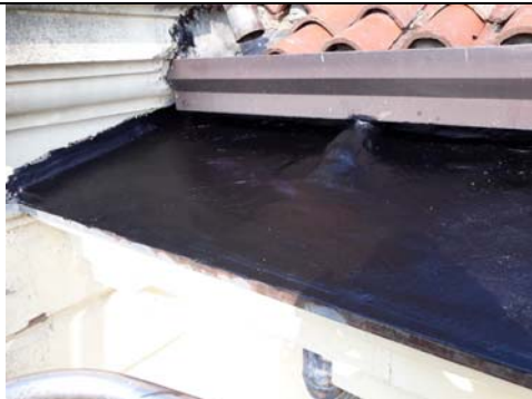
Idrovora Rebosola di Pegolotte di Correzzola. Sistemazione dei cornicioni deteriorati dell'impianto idrovoro
